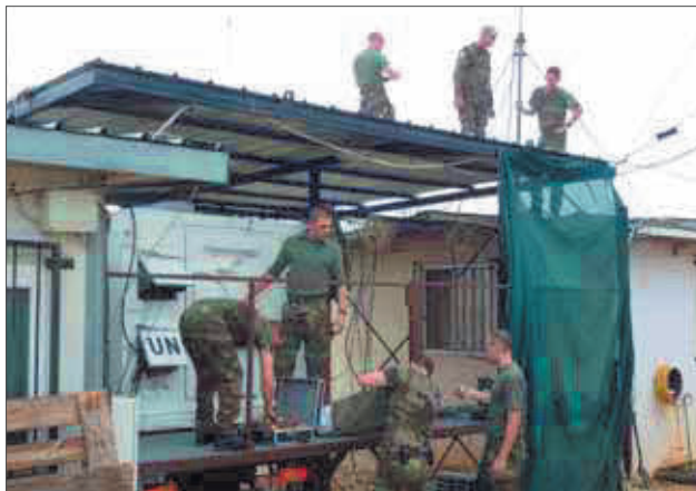
Entretien des stations de commutation par la cellule système de communication
