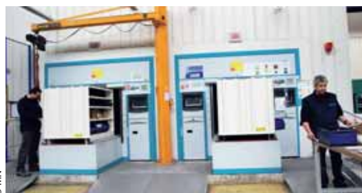
Pupitres de contrôle d'un transstockeur : 7 millions d'articles référencés sont stockés aux magasins MY31 et MA12 du SLM de Toulon, permettant un entreposage optimisé (en surface) et automatisé (manutention).
