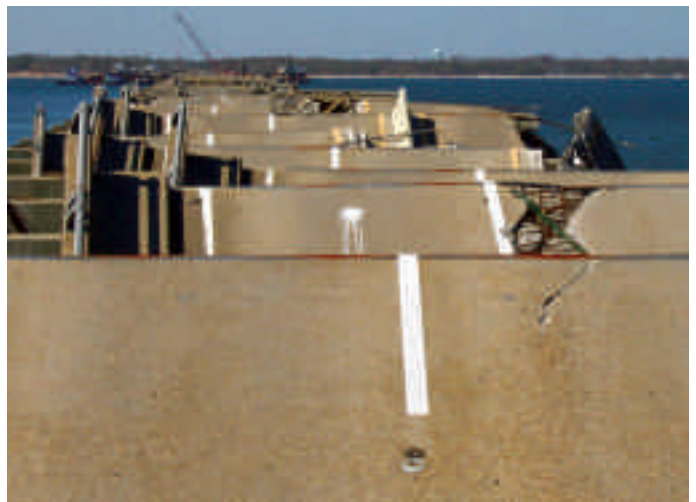
Restes d'un pont après le passage d'un ouragan (© DR).
